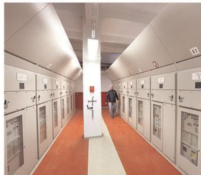
Im Inneren des Umspannwerks herrscht hohe Spannung
